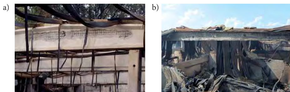
Rys. 5.11. Odpryskiwanie betonu w dźwigarach strunobetonowych [fot. autora]
