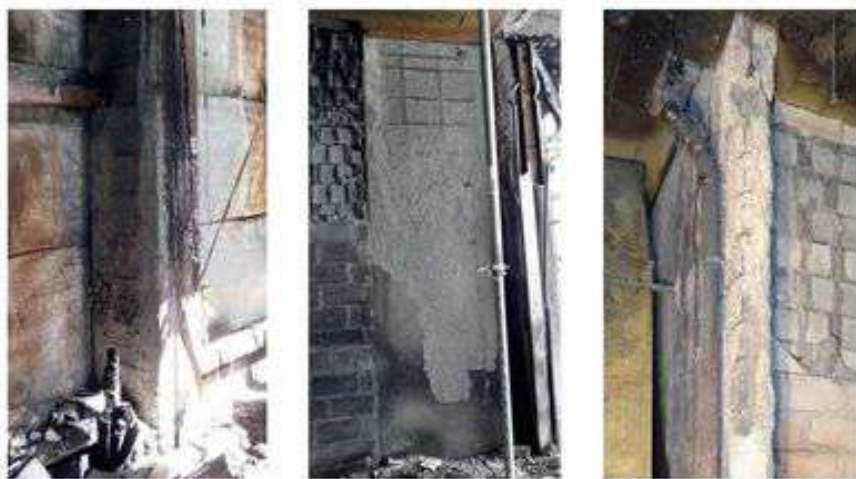
Rys. 5.12. Odpryskiwanie betonu w słupach żelbetowych [fot. autora]
