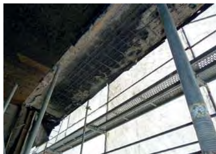
Rys. 5.9. Odpryskiwanie betonu płyty balkonu [fot. autora]
