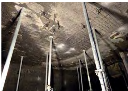
Rys. 5.8. Odpryskiwanie betonu płyty stropowej [fot. autora]
